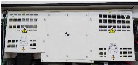
Abbildung 126: Kühlgerät Wechselrichterseite – Rev04
