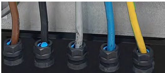
Abbildung 42: Kabeldurchführungen – AC-Anschluss (exemplarisch)
