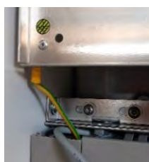
Abbildung 115: Erdungskabel Abdeckblech Wechselrichter
