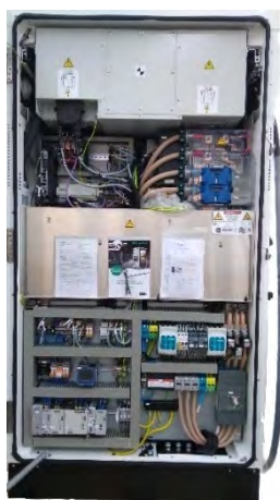
Abbildung 5: Tür Wechselrichterseite geöffnet (Abbildung exemplarisch)
