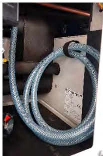
Abbildung 187: Kühlmittelschlauch korrekt verräumt
