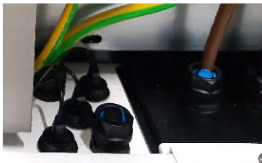
Abbildung 41: Kabeldurchführungen – Kommunikationskabel und Kundenschnittstelle
