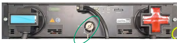
Abbildung 58: SRC4 Schlüsselschalter in Position „off“
