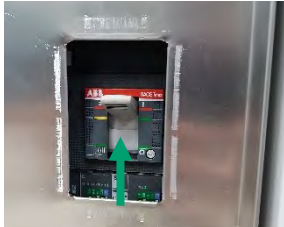
Abbildung 167: Hauptschalter in Position „ON“
