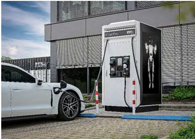
Abbildung 104: Ladevorgang für Elektro-Autos
